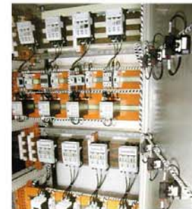
Detalle de un tablero con algunos de los 70 Simocode suministrados.
